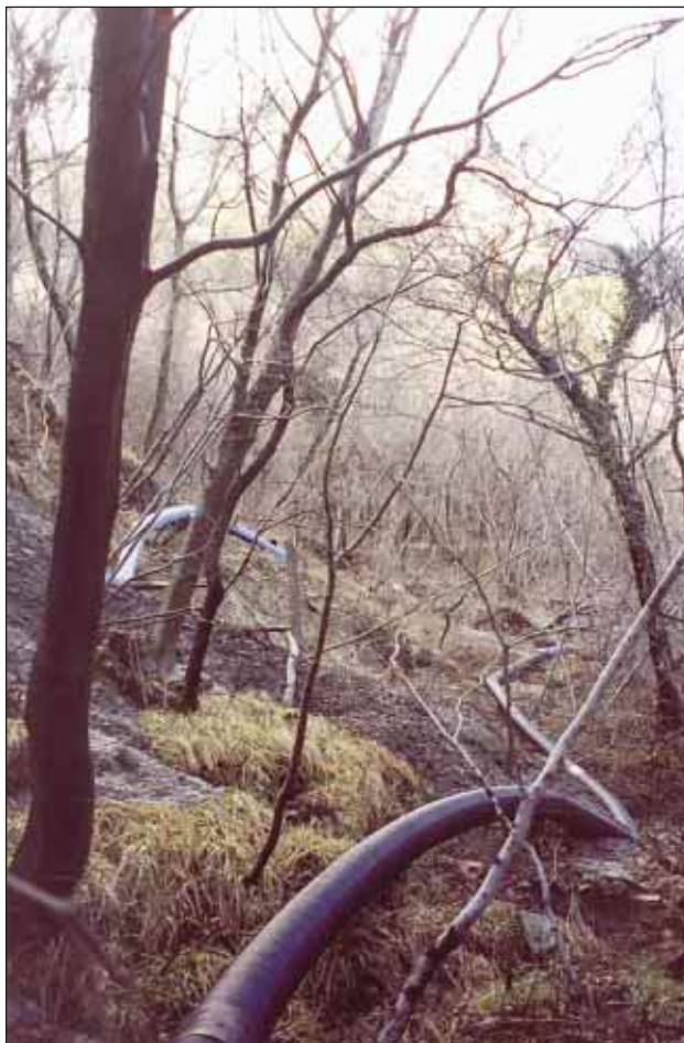
Slika 13. Po plastičnih ceveh odteka voda izza plazu, 30. december 2000. (foto: M. Kovač)
