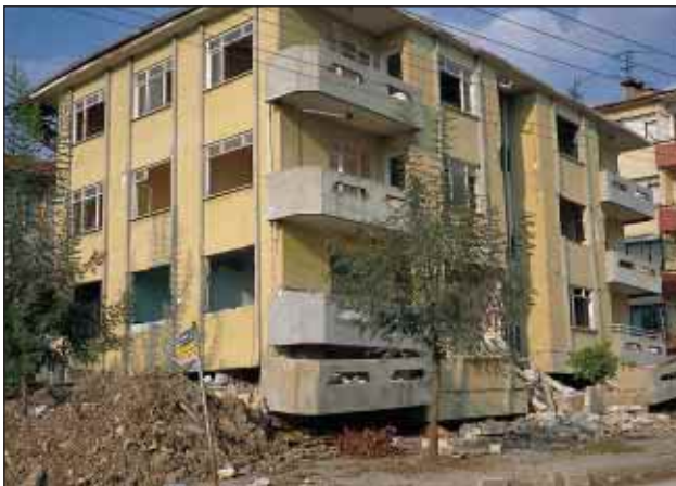
Slika 6. Šele pogled od blizu je razkril, da pritličja sploh ni več (turški potres). (foto: R. Vidrih) Figure 6. Only a closer examination revealed that the ground floor no longer exists (Turkey earthquake). (photo: R. Vidrih)
