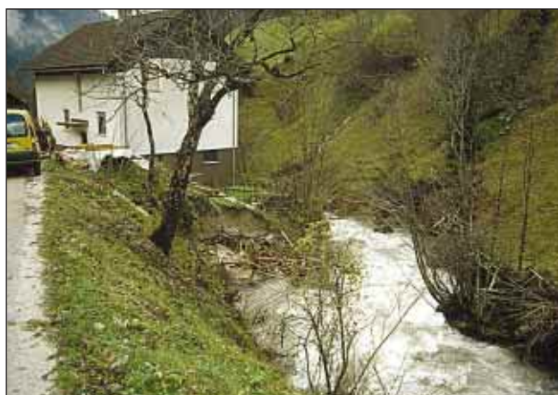
Slika 4. Češnjica v Rudnem – bočna erozija ogroža stanovanjski objekt (foto: A. Klabus) Figure 4. Češnjica v Rudnem – a residential building endangered by lateral erosion (photo: A. Klabus)
