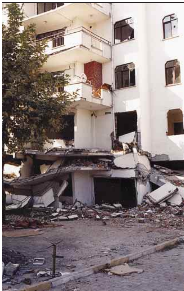
Slika 7. Popolnoma porušeno štiri leta staro naselje petnadstropnih blokov v mestu Seymen. Vzroki za porušitev nadstropij so bili nesegregiran beton, gladka armatura, redka stremena in slabi prehodi armature. (foto: M. Godec)
