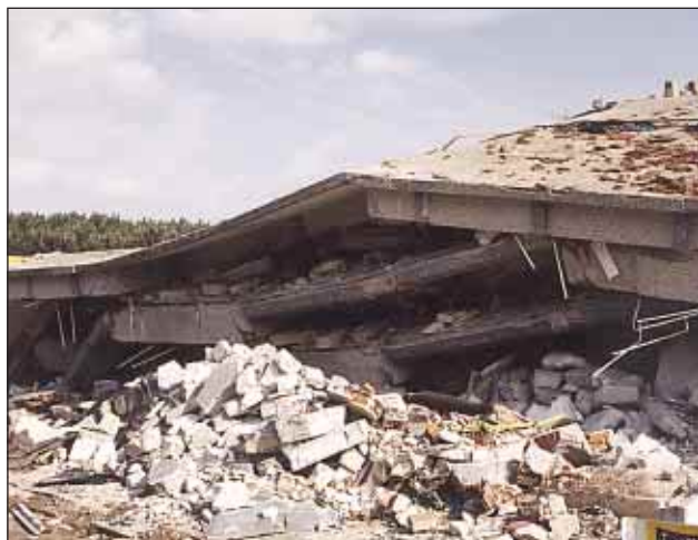
Slika 5. Del štirinadstropnega bloka v Adapazarju se je sesedel kot palačinke. (foto: M. Godec)
