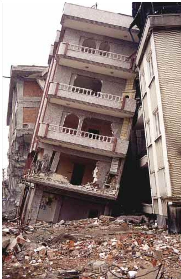
Slika 9. Zaradi izredno slabih geoloških razmer (slaba nosilnost tal, zasičenost z vodo), je ponekod prihajalo do nag-njenja ali posedanja objektov (primer na sliki je iz mesta Adapazarj). (foto: M. Godec)
