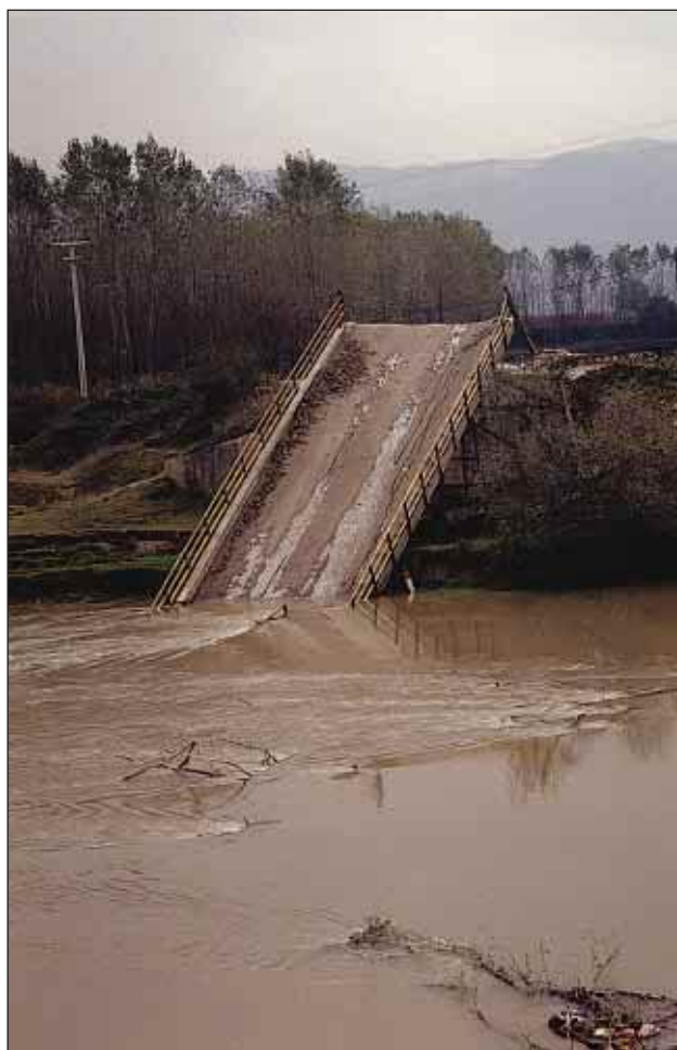
Slika 12. Eden redkih porušениh mostov. V splošnem je bilo poškodb na mostovih (tudi majhnih) zelo malo. To kaže na to, da je nadzor nad javnimi financami boljši kot v zasebnem sektorju. (foto: M. Godec)
