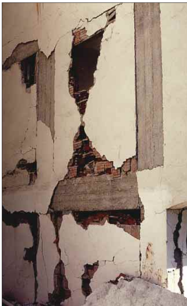
Slika 8. Detajl porušitve bloka v Seymenu (slika 7). Ko polnila v nadstropju popustijo, se to obnaša kot mehka etaža. (foto: M. Godec)
