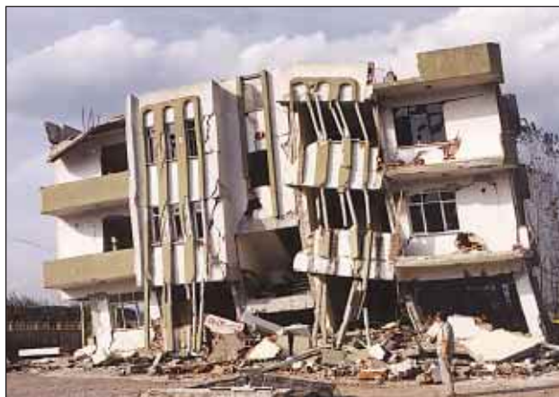
Slika 6. Porušitev pritličja, v katerem je bila trgovina. Objekt se je »zapeljal« v stran za višino pritličja (2,8 m). V zgradbi je bilo med potresom pet družin (okoli 30 ljudi) in nihče ni bil poškodovan. (foto: M. Godec)
