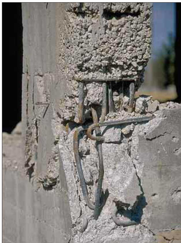
Slika 6. Neustrezna armatura vogalnega vozlišča (foto: M. Fischinger)
