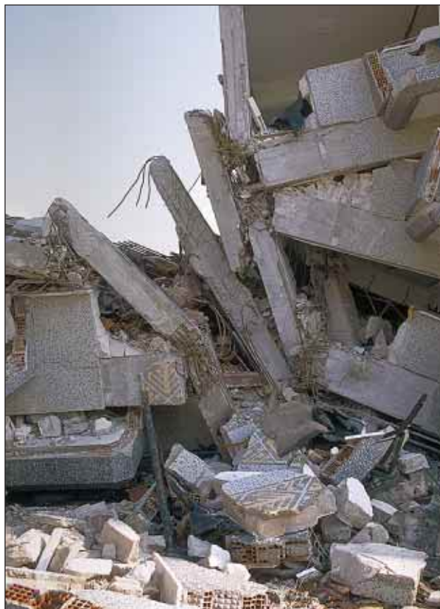
Slika 1. Katastrofalna porušitev stavbe (foto: M. Fischinger) Figure 1. Catastrophic collapse of a building (photo: M. Fischinger)
