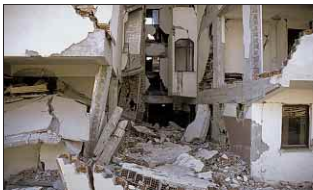
Slika 5. Izpad polnil iz okvira (foto: M. Fisching) Figure 5. Infills have fallen out of the frame (photo: M. Fisching)
