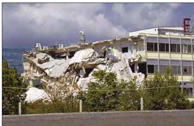
Slika 4. V večjem delu tovarne »Faran« so bile težko poškodovane konstrukcije Figure 4. Part of the »Faran« factory building collapsed and the remainder suffered serious structural damage
