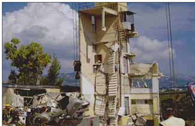
Slika 8. Močno poškodovana tovarna »Ricomex«, kjer je bilo na enem mestu največ žrtev potresa (več kot 30) Figure 8. The collapse of the »Ricomex« factory caused the highest death toll in a single place (more than 30)
