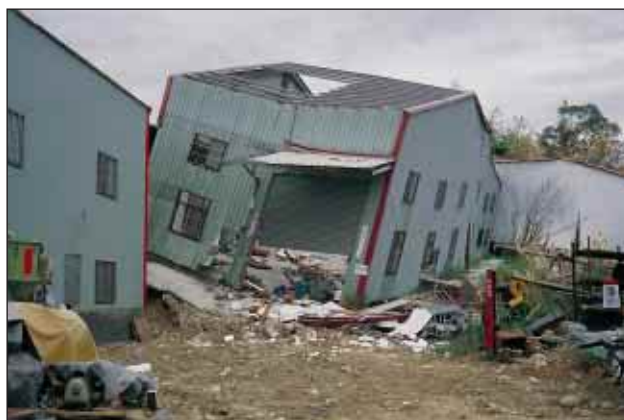
Slika 9. Stanovanjska hiša na prelomu ne more vzdržati obremenitev, pa tudi deformacije tal ne (vertikalni premiki so bili tudi do 8 m) (foto: R. Vidrih)
