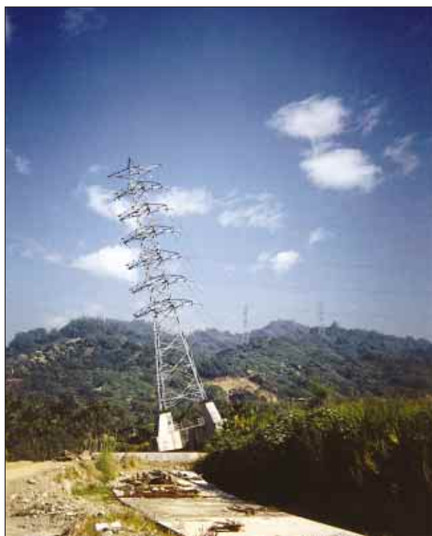
Slika 7. Posledice potresa so bile tudi na omrežju za prenos elektrike. Nagnjenje stebra je posledica lokalnih geoloških pogojev (foto: M. Godec) Figure 7. The earthquake also damaged the power supply network. The leaning pole is the consequence of local geological conditions (photo: M. Godec)
