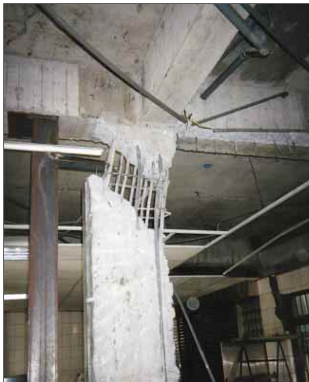
Slika 6. Tipičen primer strižnega loma stebrov (foto: M. Godec) Figure 6. A typical example of column shear failure (photo: M. Godec)
