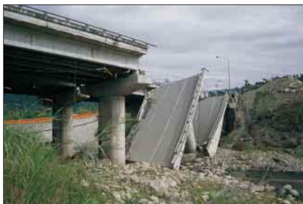
Slika 10. Vzrok porušitve mostu v Tung-Šinu je bilo slabo nalaganje prekladnih elementov v ležiščih (foto: R. Vidrih) Figure 10. The cause of the bridge collapse in Tung-Shin was the improper positioning of beams in beds (photo: R. Vidrih)
