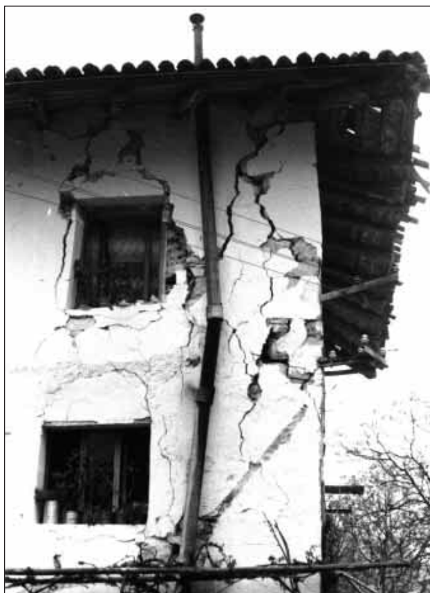
Slika 1. Že po prvih močnih potresnih sunkih 6. maja 1976 so bile v Posočju močno poškodovane številne stavbe. Na fotografiji je primer poškodb na značilni, tradicionalno grajeni hiši v Podbeli, ki je bila že ob začetku potresne aktivnosti najbolj prizadeto naselje. Fotografija je bila posneta 7. maja, ko še ni bila zaključena prva serija potresov. To stavbo so kasneje porušili, ker popravilo ni bilo več ekonomsko upravičeno (foto: M. Orožen Adamič)
