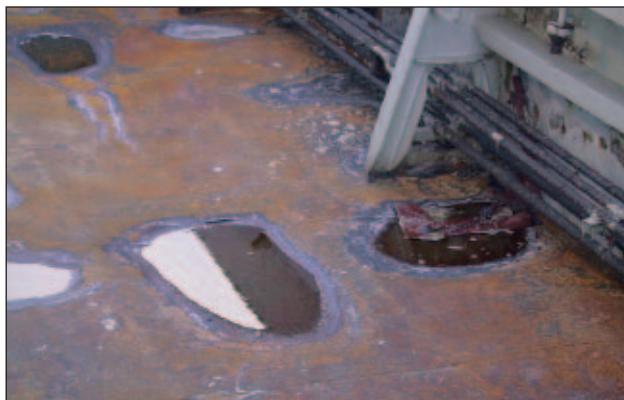
Slika 3. Posledice visokih temperatur, ki so nastale na krovu ladje (30mm pločevina) nad skladiščem 3. (foto: A. Bubnič)
