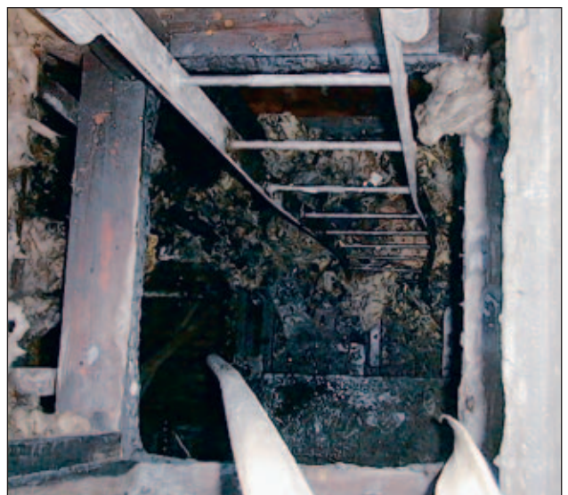
Slika 6. Pogled v notranjost skladišča št. 3 po končanem gašenju (foto: B. Koprivec)
