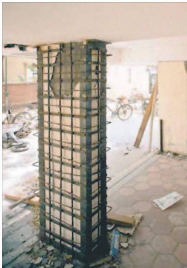
Slika 8. V Ahmedabadu so takoj po potresu poškodovane stebre nepravilno ojačali. Na sliki je razvidno, da je bilo ojačanje samo položeno na tla in ni bilo sidrano v zgornjo oz. spodnjo ploščo.
