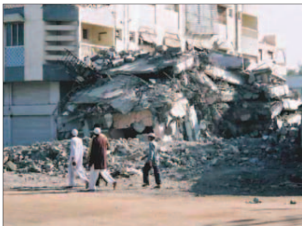
Slika 21. Obe zgradbi sta bili zgrajeni približno istočasno. Zaradi slabe gradnje se je zgradba na desni sesedla etaža na etažo.
