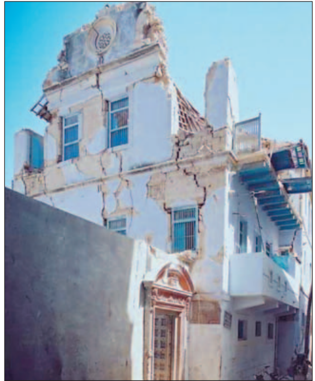
Slika 15. Trinadstropna hiša je bila težko poškodovana, vendar se ni v celoti porušila. Prvi dve nadstropji naj bi bili stari več kot 200 let, zgornje pa okoli 75 let.
