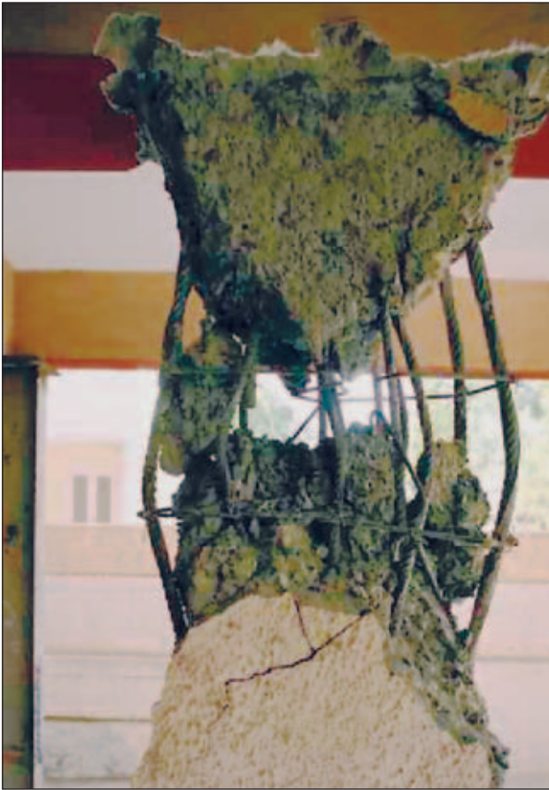
Slika 9. Pomanjkanje armature (pogosto je zelo malo stremenske armature) ima za posledico porušitev stebra v vozlišču.
