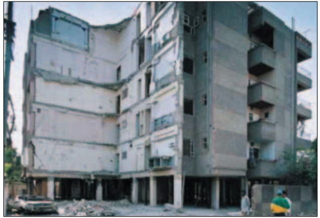
Slika 10. Značilna stanovanjska zgradba z odprtim pritličjem, kjer so bile garaže. Takšno pritličje se med potresom obnaša kot mehka etaža (ob močnem potresu stebri v mehki etaži ne zmorejo prevzeti uvedenih potresnih sil).
