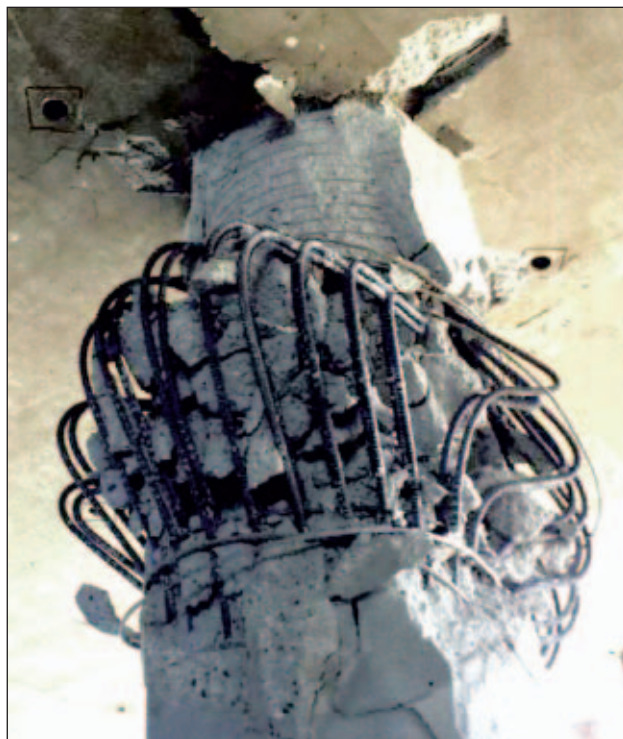
Slika 1. Na mestu z redkejšimi stremeni je betonsko jedro mostnega stebra razpadlo. Gosta spirala v bližini plošče pa je jedro obvarovala (foto: M. Fischinger)
