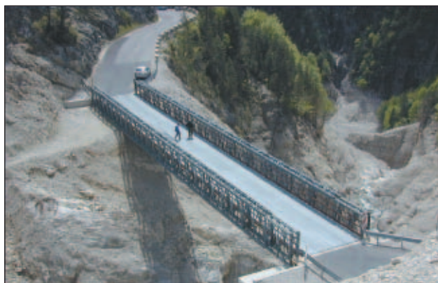
Slika 2. Montažni most pri Mlinču, zgrajen po poružitvi starega mostu, vidni so sledovi plazov v kanjonu (foto: R. Fazarinc)
