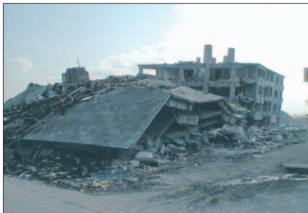
Slika 3b. Popolna porušitev AB-konstrukcije
