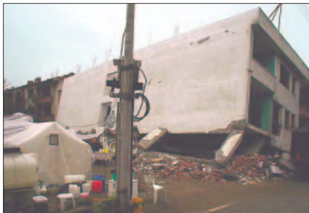
Slika 1. Porušitev konstrukcije z mehko etažo
