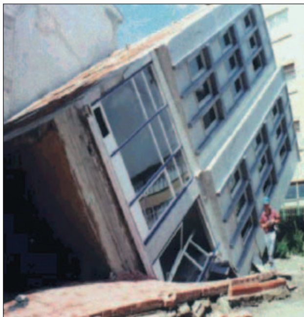
Slika 5. Prevrnitev zaradi likvefakcije temeljnih tal
