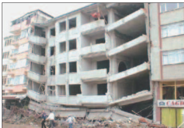
Slika 4. Nepopravljivo poškodovana konstrukcija
