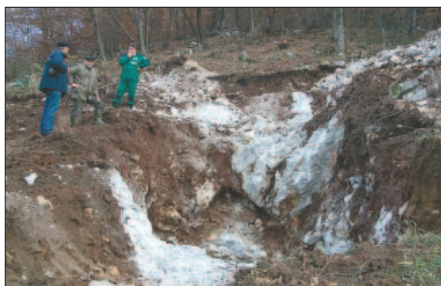
Slika 7. Primer izkopa na lokaciji Črešnjevec (stanje 5. 12. 2001). Opravljen je izkop v matično kamnino do globine cca 4,50 m.
