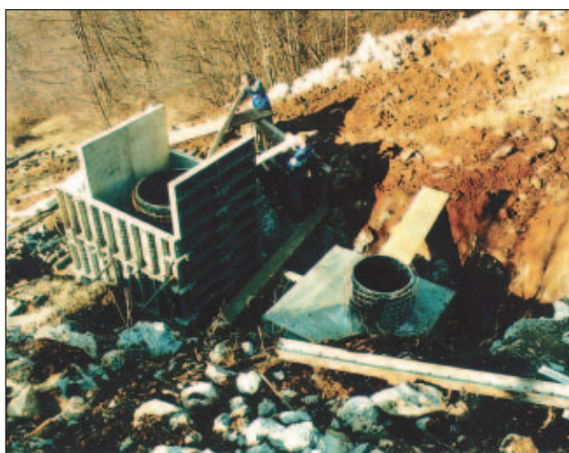
Slika 13. Stanje del na lokaciji Črešnjevce 30. januarja 2002 (opravljena betonska dela, elektroenergetski in telekomunikacijski kabel sta bila položena 4. 2. 2002)
