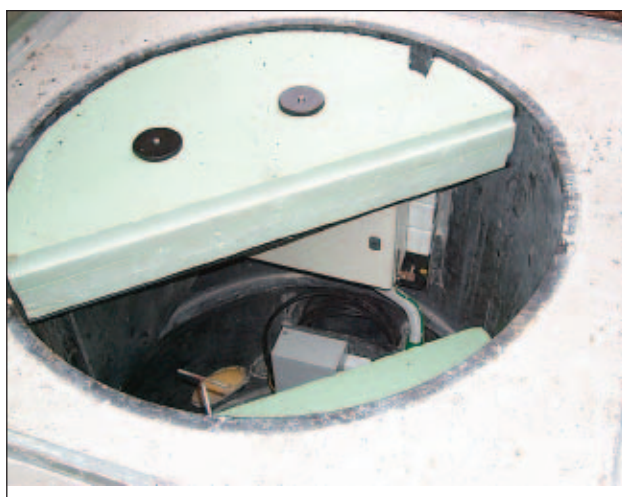
Slika 15. Pogled v jašek z merilnimi instrumenti. Senzor je postavljen v vrtino pod jaškom.
