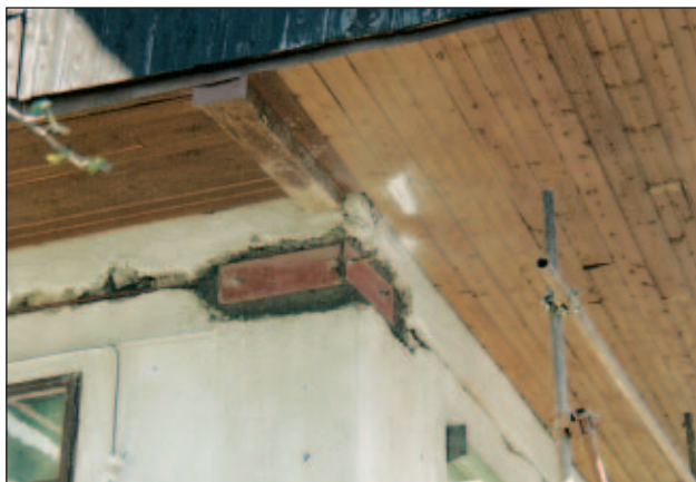
Slika 4. Izvajanje obojestranske zidne vezi – detajl vogala. Po končani obnovi so ti posegi nevidni, v celoti se ohrani arhitektura objekta.
