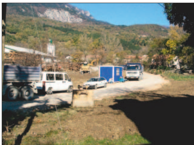
Slika 22. Gradnja ceste skozi Lokavec za odvoz materiala Figure 22. Construction of a road through Lokavec for waste removal
