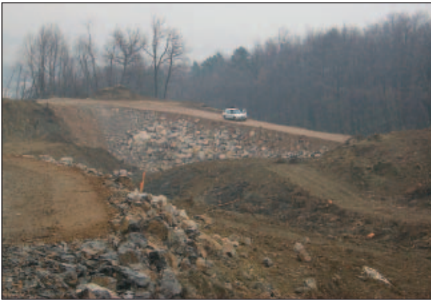
Slika 14. Kamnita pregrada za ustavitev drobirskih tokov, ki je v grapi potoka Grajšček nad vasjo Lokavec.
