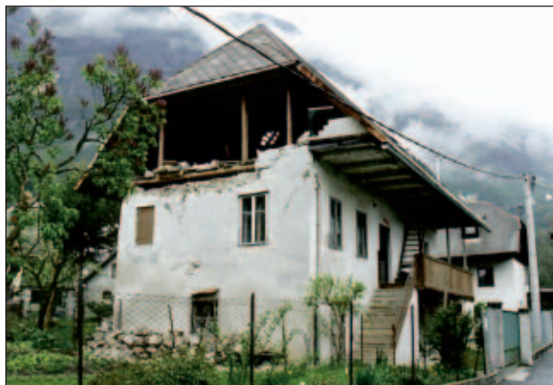
Slika 1. Tipične potresne poškodbe na starejši bovški stano-vanjski hiši.
