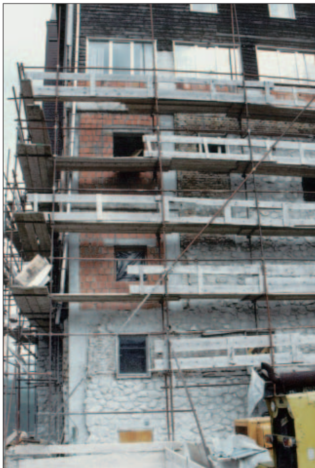
Slika 6. Celoten hotel je bil konstrukcijsko ojačan: porušene zidove so zamenjali armirani opečni zidovi in vogalne armiranobetonske vezi. Razmeroma draga popotresna obnova je bila ekonomsko opravičena le zaradi nedostopne lege objekta in specifične arhitekture.
