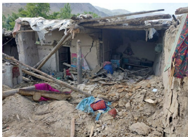
Slika 6: Poškodovan dom v Afganistanu po potresu junija 2022 (Vir: https://commons.wikimedia.org/wiki/File:June_2022_Afghanistan_earthquake_damage_2.jpg )
