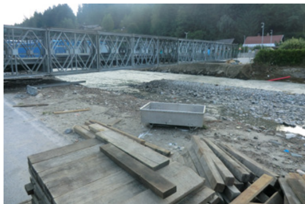
Slika 5: Montažni most C-200 (foto: N. Donau)
