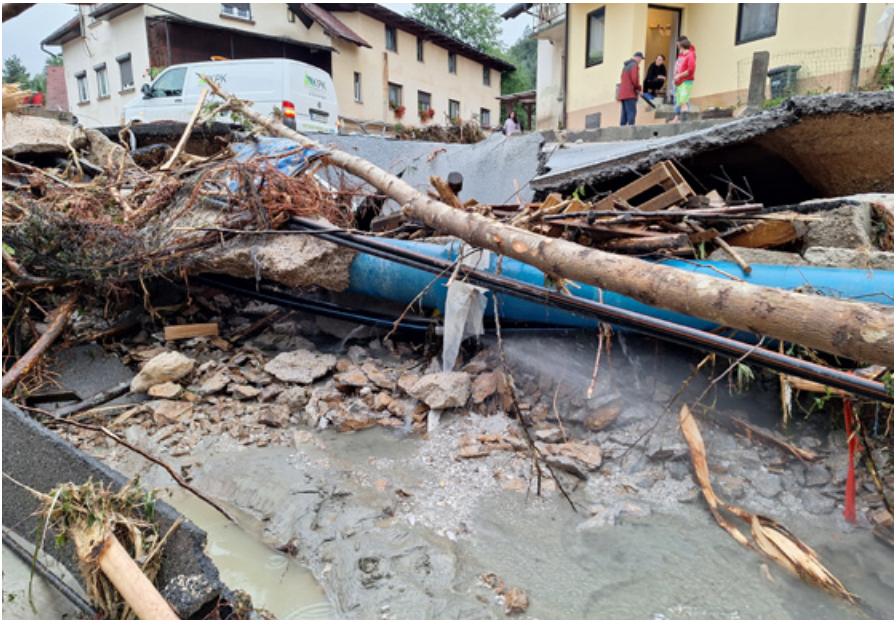
Slika 4: Poškodbe cevododa (foto: Komunalno podjetje Kamnik, d. o. o.)
