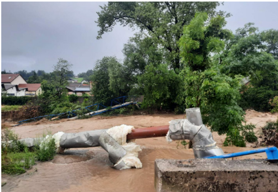
Slika 2: Poškodbe primarnega cevovoda in nosilne konstrukcije (foto: Komunalno podjetje Kamnik, d. o. o.)
