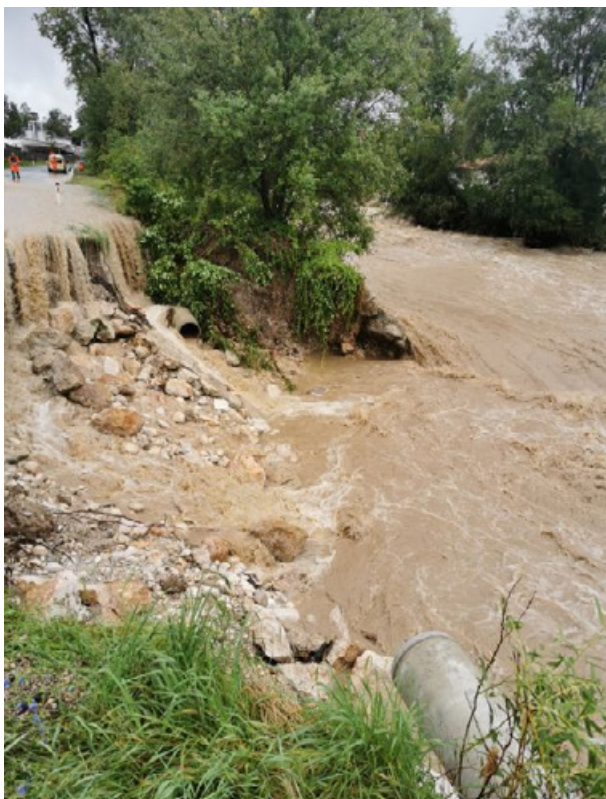
Slika 3: Zemeljski usad in poškodba primarnega cevovoda DN 500 (foto: Komunalno podjetje Kamnik, d. o. o.)
