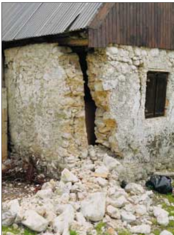
Slika 9. Močno poškodovana zgradba nad Lepeno (poškodbe 3. do 4. stopnje) (foto: R. Vidrih)
