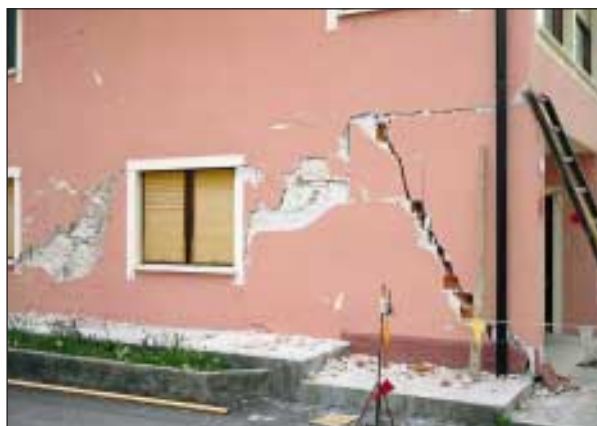
Slika 14. Močno poškodovana novejša stanovanjska hiša v Mali vasi v Bovcu (poškodba 5. stopnje) (foto: R. Vidrih) Figure 14. Heavily damaged, relatively new residential house at Mala vas in Bovec (grade-5 damage). (photo: R. Vidrih)
