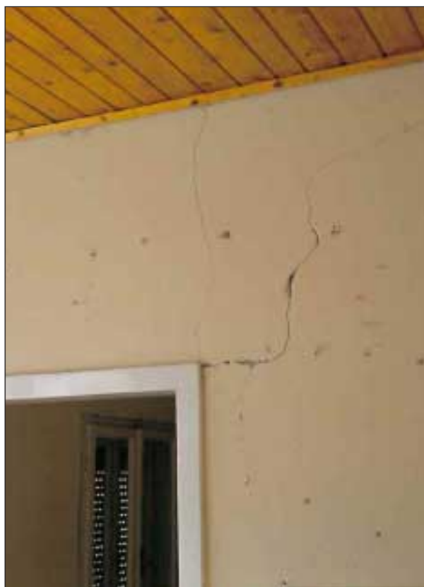
Slika 3. Lasaste razpoke v ometu v Kal-Koritnici (poškodba 1. stopnje) (foto: R. Vidrih)
