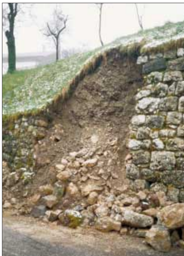
Slika 5. Podrt podporni zid v Drežnici (poškodba 2. stopnje) (foto: R. Vidrih)
