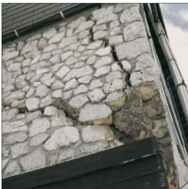
Slika 7. Poškodbe Ski hotela na Voglu (poškodba 3. stopnje) (foto: R. Vidrih)
