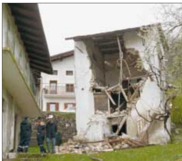
Slika 12. Popolnoma uničen objekt v Magozdu nad Kobari-dom (poškodba 5. stopnje) (foto: R. Vidrih) Figure 12. Completely destroyed building at Magozd above Kobarid (grade-5 damage). (photo: R. Vidrih)
