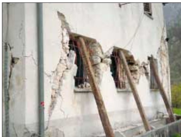
Slika 13. Uničena sirarna na planini Polog nad Tolminom (poškodba 5. stopnje) (foto: R. Vidrih) Figure 13. Destroyed cheese dairy on the Polog plain above Tolmin (grade-5 damage). (photo: R. Vidrih)
