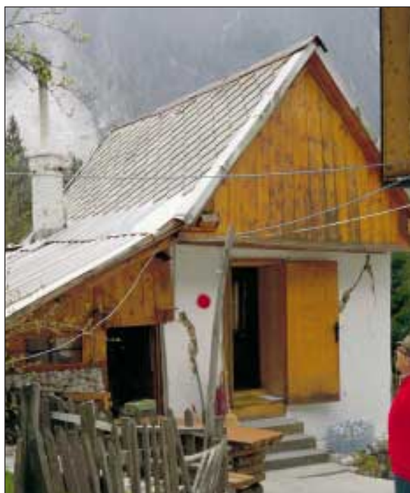
Slika 4. Zasukani dimnik v dolini Lepene (poškodba 2. stopnje) (foto: R. Vidrih)
