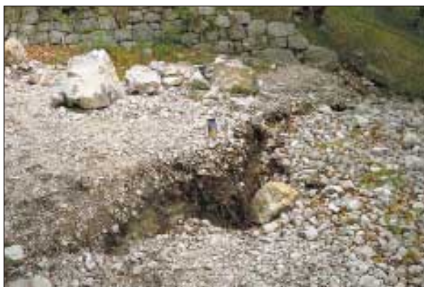
Slika 8. Prekrasna pot, ki s planine Polog vodi do izvira reke Tolminke, je skoraj v celoti poškodovana. Na začetku jo je zasul podor, višje pa jo je razdejalo plazenje, ki je povzročilo v dolžini več deset metrov nastanek decimetrskih razpok. (foto: R. Vidrih)
