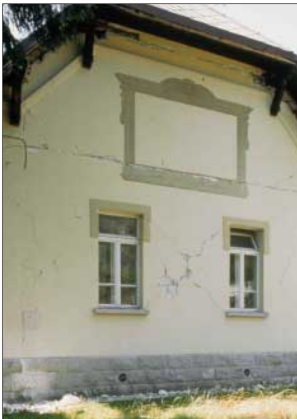
Slika 6. Bovec: vodoravna razpoka, nastala zaradi monolitne stropne plošče (foto: M. Tomažević)
