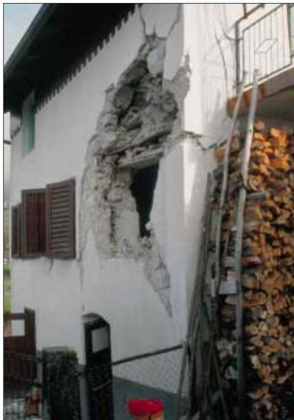
Slika 2. Drežniške Ravne: poškodovan vogal in razpadel kamniti zid v območju preklade (foto: M. Tomažević)
