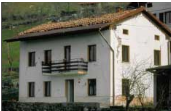
Slika 3. Drežniške Ravne: strizne razpoke v zidovju kamnite hiše, kjer so bili leseni stropi zamenjani z armiranobetonskimi ploščami, zidovje pa ni bilo injektirano (foto: M. Tomažević)
