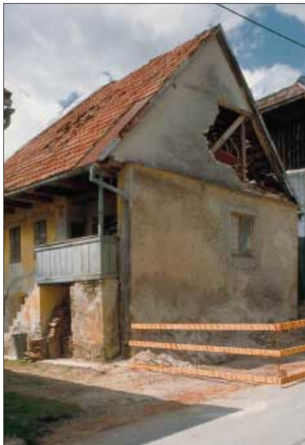
Slika 1. Bovec: delno porušen zatrep tipične kamnite hiše (foto: M. Tomažević)
