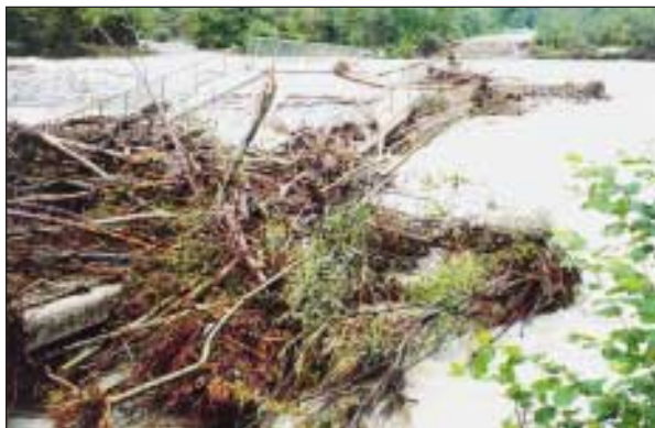
Slika 5. Porušen most na Nadiži (foto: M. Černe) Figure 5. Destroyed bridge on the Nadiža river (photo: M. Černe)
