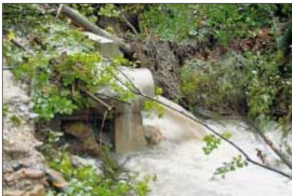
Slika 3. Pritok Davče v Zgornji Davči: Poškodbe prepusta - posledica neustreznega iztoka, nestabiliziranega dna struge ter zamašenega vtoka – neurje septembra 1995 v Selški dolini (foto: A. Klabus)
