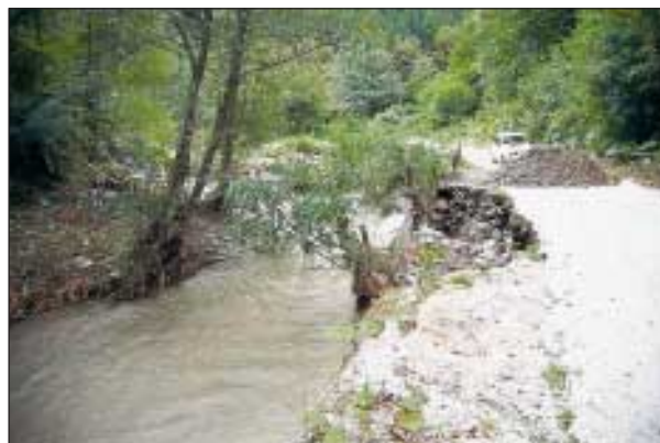
Slika 6. Zadnja Sora: posledice neustreznega temeljenega in nestabiliziranega podpornega zidu – neurje septembra 1995 v Selški dolini (foto: A. Klabus)
