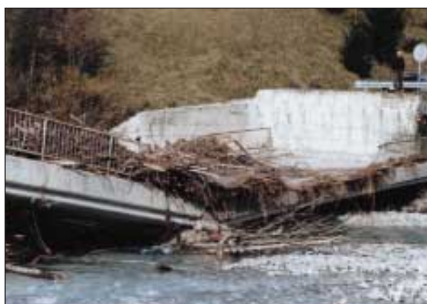
Slika 7. Levi obrežni opornik z vgreznjenim levim srednjim podpornikom: na vrhu opornega zidu se vidi deset ležišč za deset prefabriciranih nosilnih gred; levo nosilno polje je zdrsnilo z ležišč in padlo 2,5 do 3 m globoko na temelj opornika (foto: J. Eržen)
