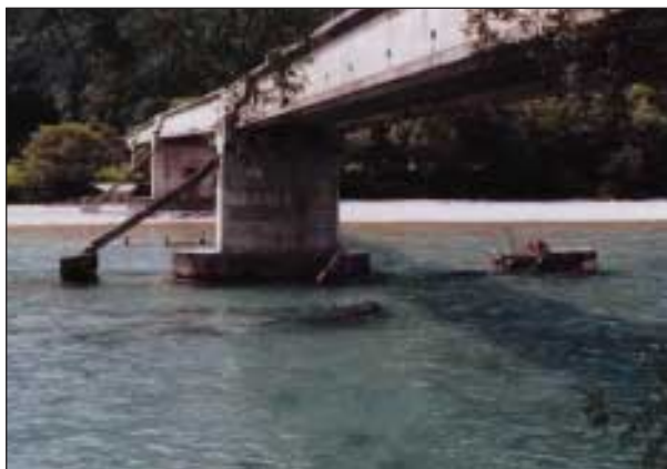
Slika 10. Most pri Kamnem: v ospredju slike je poseđeni podpornik; približno 30-centimetrski posed se na legi obeh razponskih konstrukcij komaj opazi; polomljene ali že povsem odnesene poševne železobetonske grede so t. i. rogovile, ki so bile namenjene za zaščito podpornih mostnih sten pred poškodbami, ki jo je povzročila hlovovina v časih, ko so jo še plavili; danes to opravijo tovornjaki; ni pa razumljivo, zakaj so rogovile tudi na dolvodni strani mostu. (foto: S. Trček)
