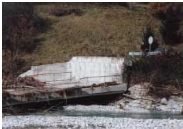
Slika 8. Levi obrežni opornik z dolvodne strani: desno od mostne konstrukcije se vidi z lomljencem tlakovan levi breg; čeprav je voda drla tudi po tem tlaku, kamnov ni mogla iztrgati iz ležišč (foto: J. Eržen)
