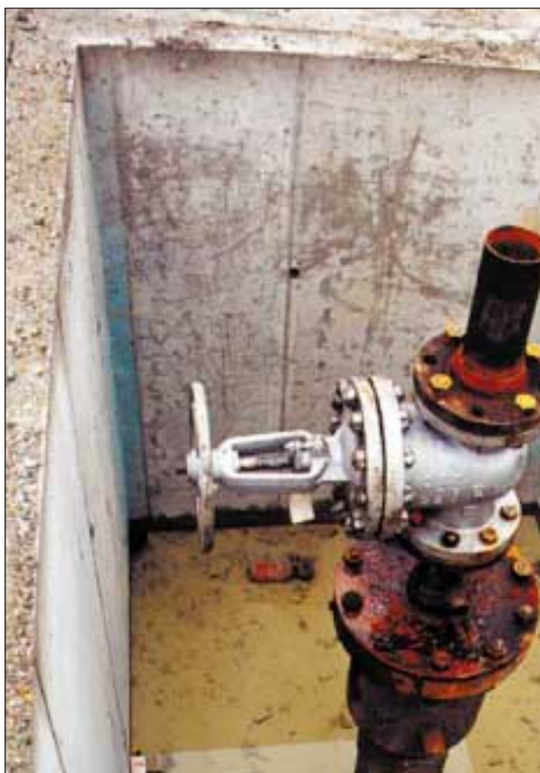
Slika 15. Opuščena vrtna Fi-14 v zaključni fazi sanacije (foto: M. Smodiš) Figure 15. Abandoned Fi-14 well in the final phase of rehabilitation (photo: M. Smodiš)
