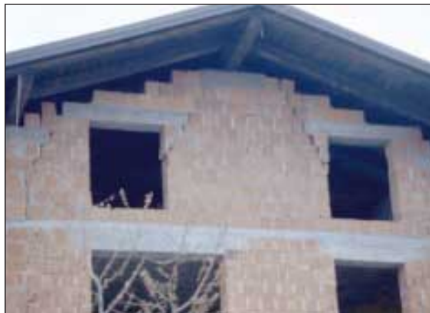
Slika 2. Hiša brez navpičnih vezi in z neustreznimi vodoravnimi vezmi, močno poškodovana med potresom v Posočju leta 1998 (foto: Matej Fischinger)
