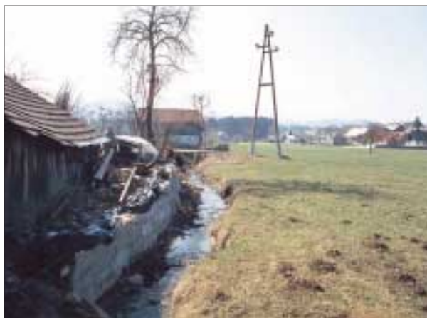
Slika 4. Homšnica pri hiši Mislinjska Dobrava 25 – okolju neprimerni betonski zidovi (foto: Z. Fujs). Figure 4. Homšnica at Mislinjska Dobrava 25 – environmentally unfriendly concrete walls (photo: Z. Fujs)
