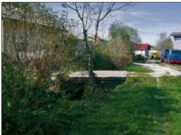
Slika 5. Homšnica pri hiši Šmartno 154: črne gradnje, – premostitev brez vodnogospodarskih soglasij (foto: Z. Fujs). Figure 5. Homšnica at Šmartno 154 – bridging structure erected without approval of the water management authorities (photo: Z. Fujs)
