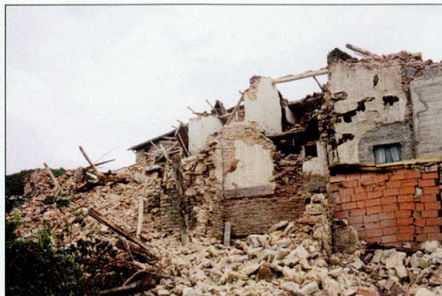
Slika 5. Porušena starejša hiša v vasi Cese (foto: M. Godec)
