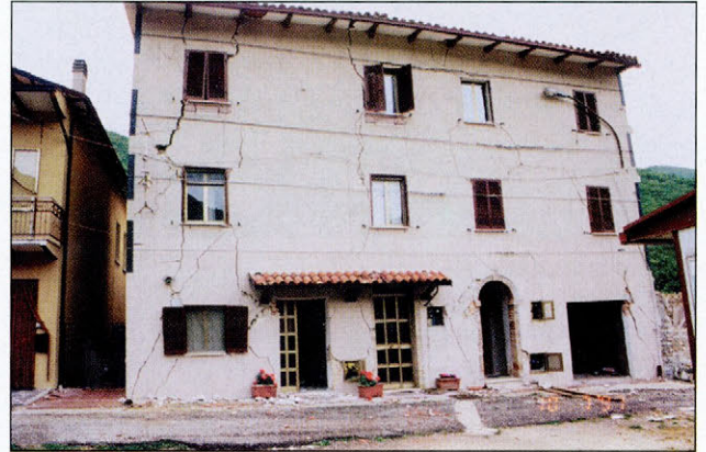
Slika 8. Aggi: hišo so gasilci začasno povezali z jeklenimi vrvmi, da ne bi poškodovala sosednjega objekta (rumena hiša), ki je potres prestal skoraj brez poškodb.
