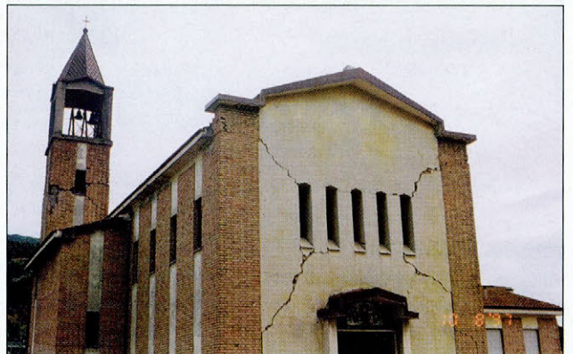
Slika 9. Globoke razpoke na fasadi cerkve in zvonika v kraju Nocera Scalo
