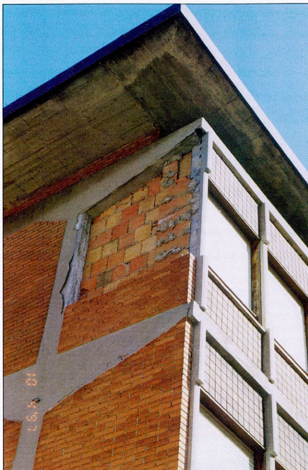
Slika 11. Pioraco: poškodbe na fasadi armirano- betonske stavbe
