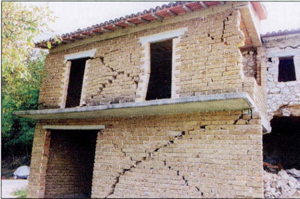
Slika 6. Na nedokončani hiši v kraju Camino so lepo vidne X-razpoke med zidaki iz tufa.
