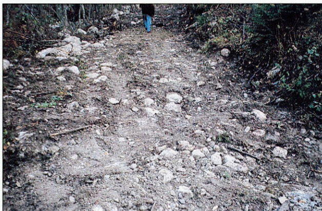
Slika 1. Uničena obrabna in nosilna plast zaradi hudega naliva (foto: J. Beguš)
