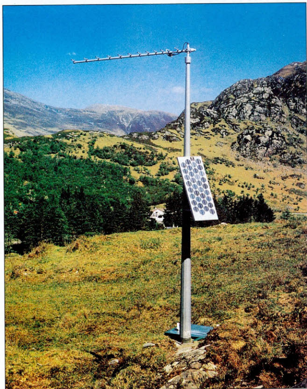
Slika 2. Potresna opazovalnica na severozahodu škotskega višavja z napajanjem s sončnimi celicami (slika z naslovne strani iz (2); foto: T. Bain)
