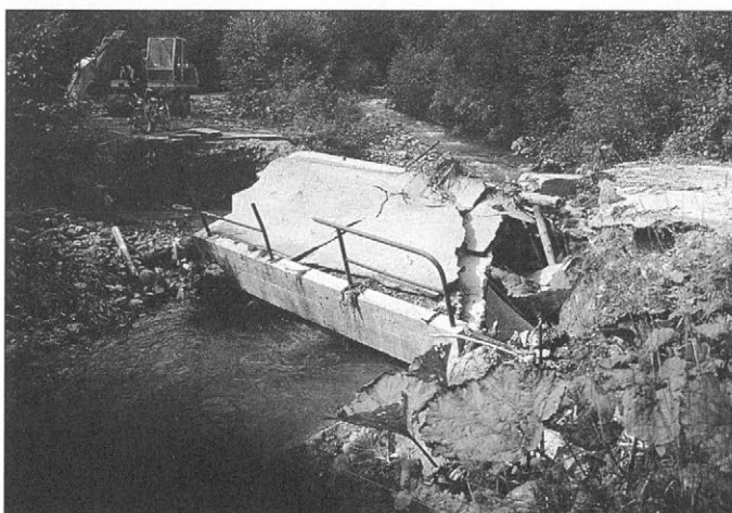
Slika 2. Davča – zgornji tek – uničen most na glavni cesti (foto: A. Klabus) Figure 2. The upper Davča – demolished bridge (photo: A. Klabus)
