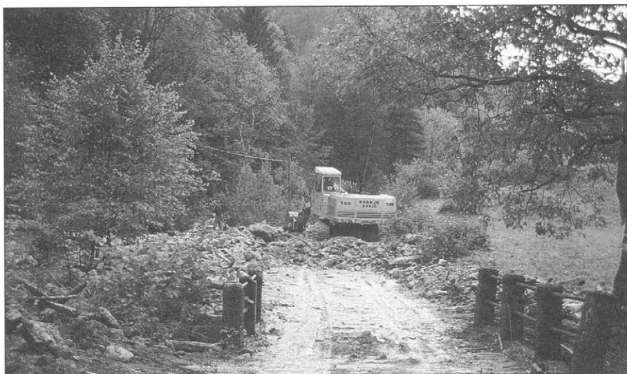
Slika 6. Kodermac (pritok Prednje Smoleve) – plavine so zatrpale prepust in lokalno cesto – intervencijsko čiščenje (foto: P. Pejakov) Figure 6. The Kodermac (tributary of the Prednja Smoleva) – cleaning of debris (photo: P. Pejakov)
