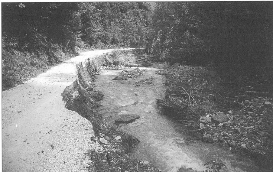
Slika 4. Zadnja Sora – zajeda na regionalni cesti Železniki–Petrovo Brdo (foto: A. Klabus) Figure 4. The Zadnja Sora – devastated Železniki–Petrovo Brdo regional road (photo: A. Klabus)
