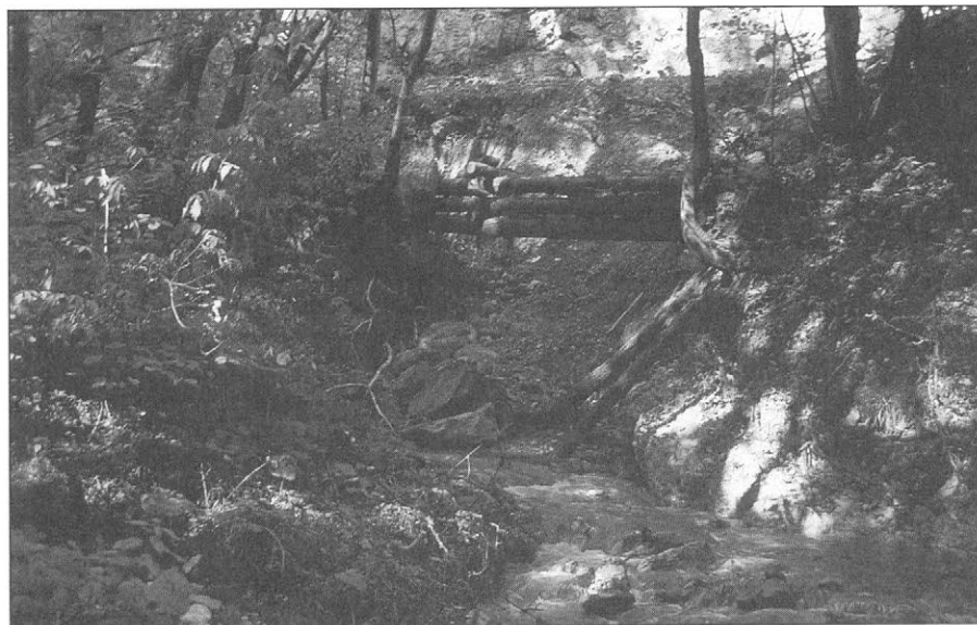
Slika 7. Hudournik Razborca nad Suhim dolom – hudourne vode Razborce so na večih odsekih ogrozile cestno telo (foto: Z. Fujs) Figure 7. The Razborca above Suhi dol – endangered road (photo: Z. Fujs)
