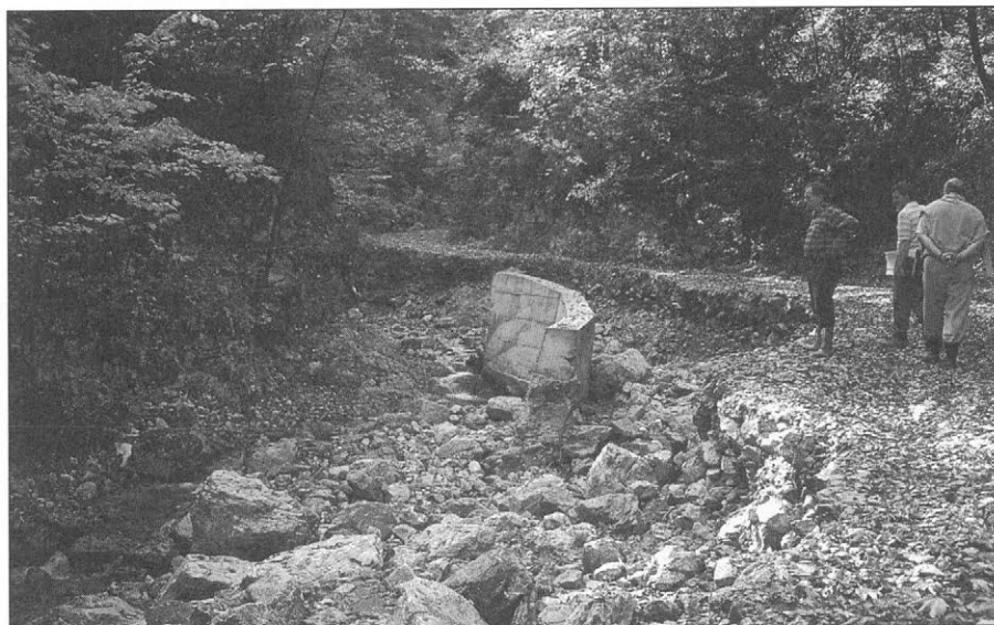
Slika 6. Suhadolnica dolvodno od Plišivškega mlina – podporni zid ceste in odnešena cesta (foto: J. Šeme) Figure 6. The Suhadolnica below Plešivski mlin – the retaining wall and damaged road (photo: J. Šeme)
