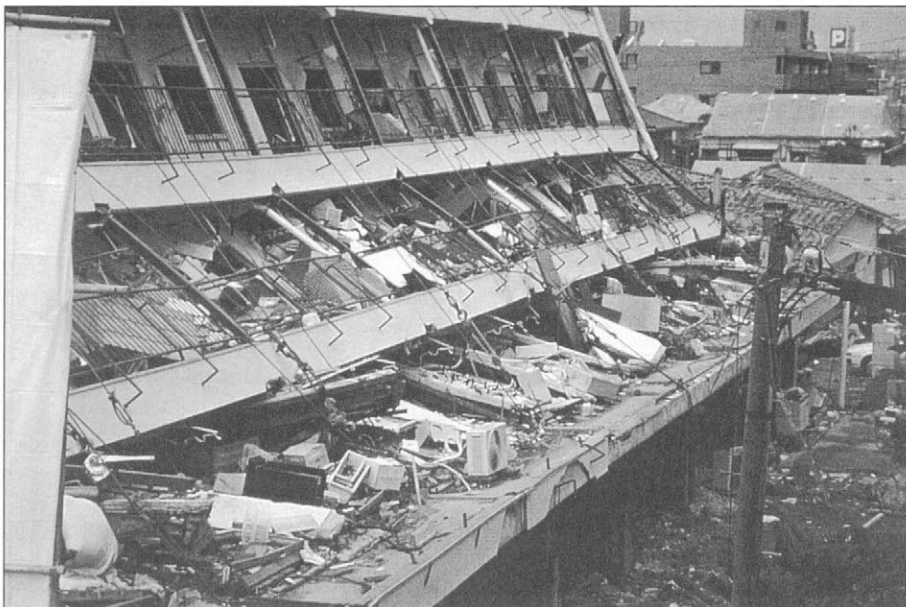
Slika 3. Kovinska štirinadstropna konstrukcija je bila najšibkejša v prvem in drugem nadstropju, ki sta se ob potresu zrušili (foto: M. Fishinger)
