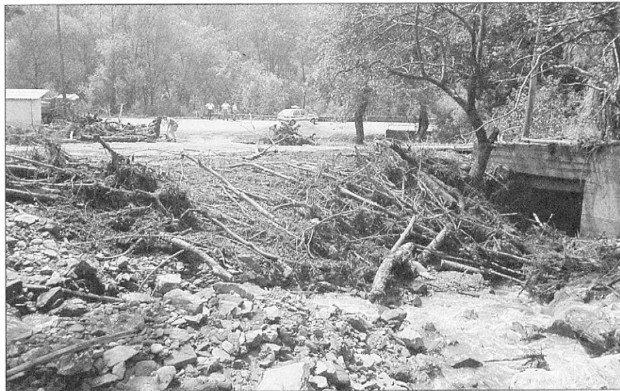
Slika 12. Neurje v Litiji in okolici 5. 7. 1994, poškodovana regionalna cesta Ljubljana-Litija pri Zgornjih Ribčah (desno od avtomobila), voda se je zaradi zamašitve pod mostom na priključku stranske ceste razlila že nad glavno cesto, za akumulacijo lesnega plavja se je začelo močno erozijsko delovanje hudourniške vode Figure 12. Vicinity of Trbovlje, July 5, 1994, the Ljubljana-Litija regional road was damaged at Zgornje Ribce (right of automobile); the clogged opening under the bridge forced the water to spill into the main road; trapped behind the wooden debris, the torrential waters began their erosive action
