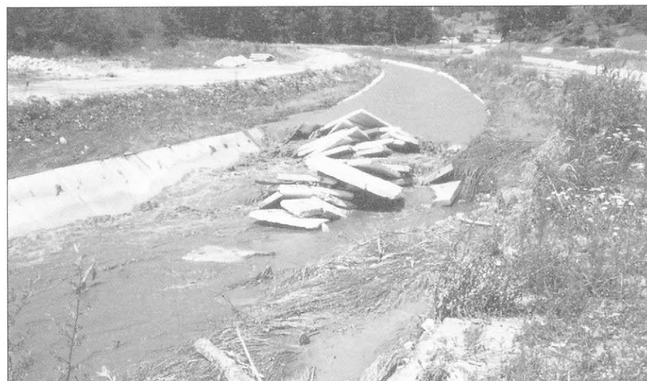
Slika 6. Kotredeščica nad Zagorjem – odnešene betonske plošče obrežnega zavarovanja so zajezile strugo Figure 6. The Kotredeščica above Zagorje – concrete slabs swept up the torrent actually stemmed its flow
