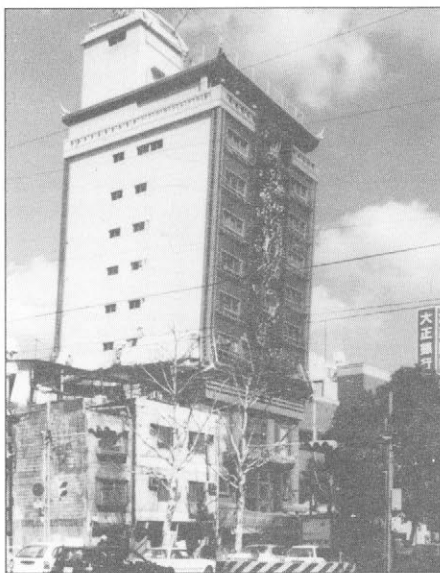
Slika 12. Porušitev zgornjega nadstropja zaradi hipno spremenjenega sistema nosilne konstrukcije Figure 12. Collapse of upper storey as a result of abruptly changed structural system
