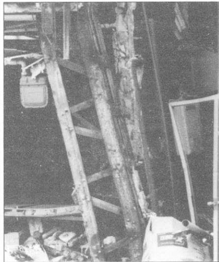
Slika 13. Porušitev jeklenega stebra sestavljenega prereza Figure 13. Failure of a steel column with composite section
