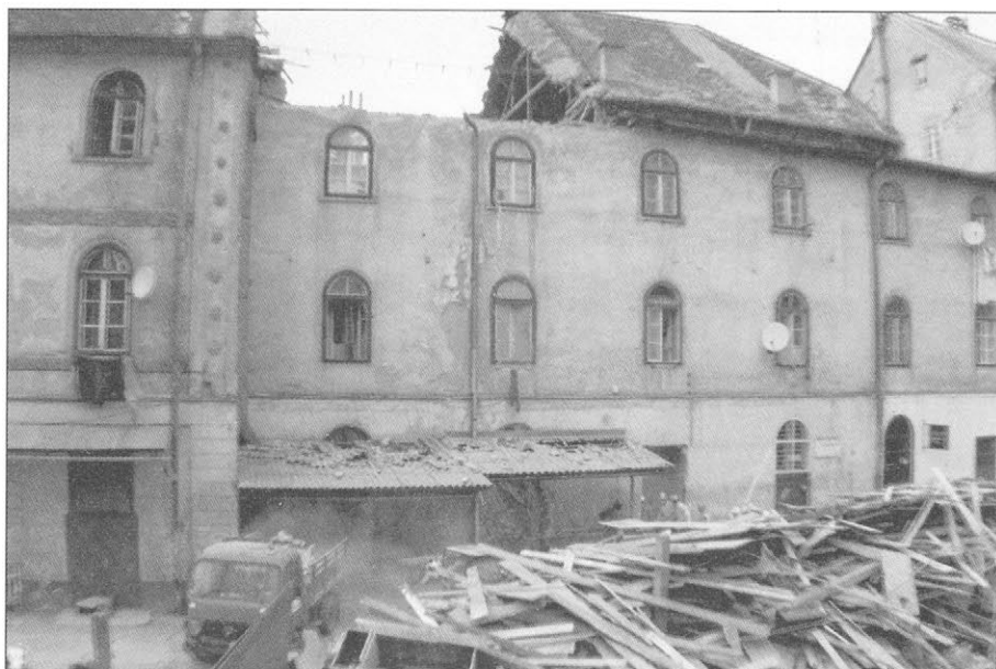
Slika 10. Odstranjevanje ruševin se nadaljuje (pogled na porušeni del Kolizeja z Župančičeve ulice); foto: Julij Jeraj
