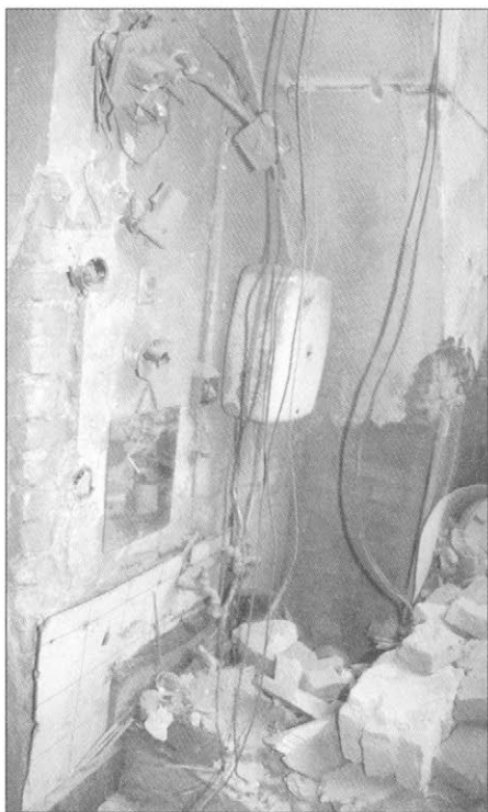
Slika 2. Potrgane električne in vodovodne instalacije vedno ogrožajo zasute ponesrečence in reševalce; foto: Julij Jeraj
