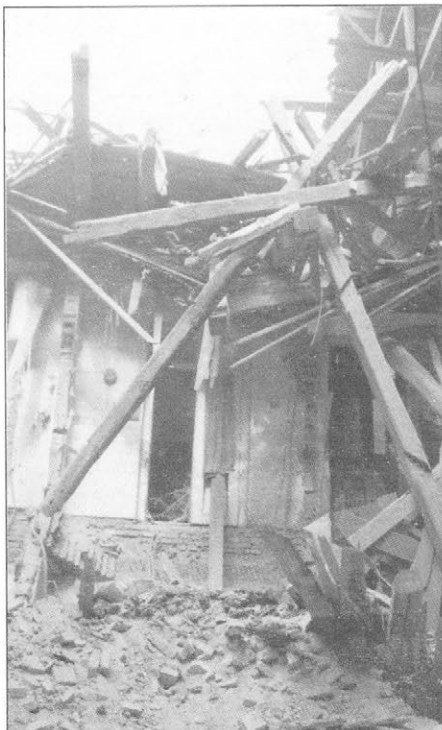
Slika 8. Potrgana in polomljena strešna konstrukcija je nevarno ogrožala reševalce; foto: Julij Jeraj
