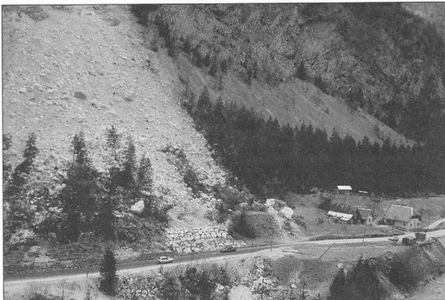
Slika 10. Spodnji del vplivnega območja skalnega podora po sanaciji. Sanacija poškodovanega cestišča in urejanje ogroženih površin je bilo veliko in zahtevno delo, ki je potekalo ob stalno prisotni nevarnosti ponovnega odloma. Melišče in ozek gozdni pas nam pričata o pokrajinski podobi pobočja pred nesrečo.
