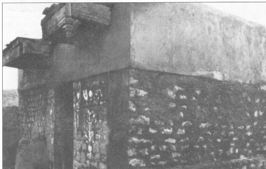
Slika 18. Izgled sanirane hiše z vencem, armirano - cementno oblogo, ki povezuje zidovje.
