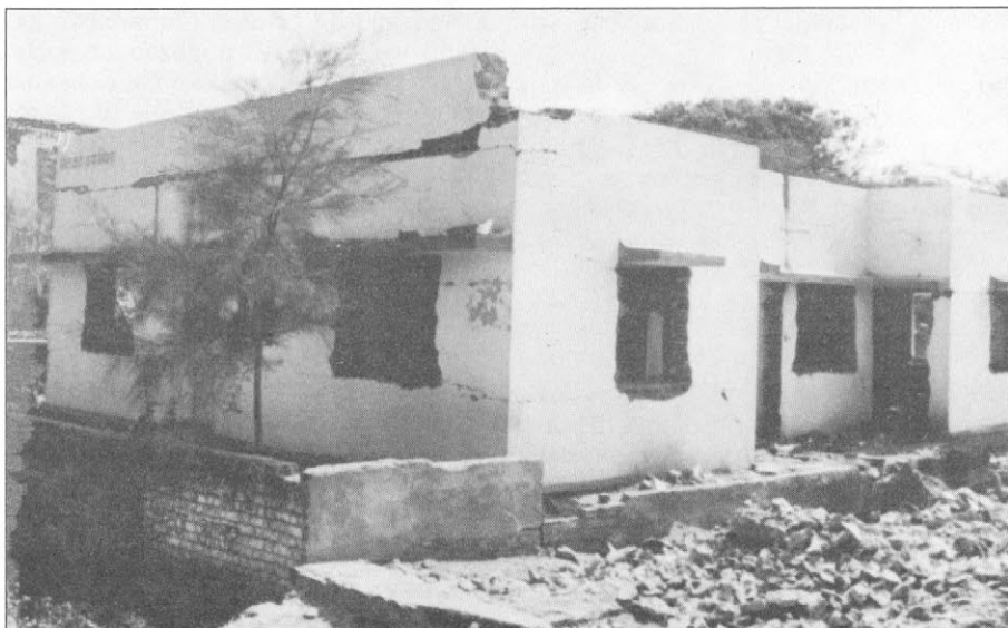
Slika 10. Slabše jo je odnesla iz opeke sezidana šola v Killariju. Opeka in malta sta slabi, zidnih vezi pa tudi ni videti.
