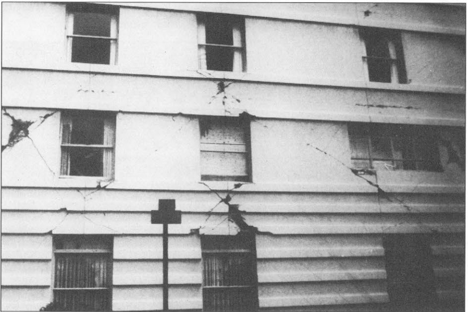
Slika 13. Strižna porušitev stene. Figure 13. Shear failure of a structural wall.
