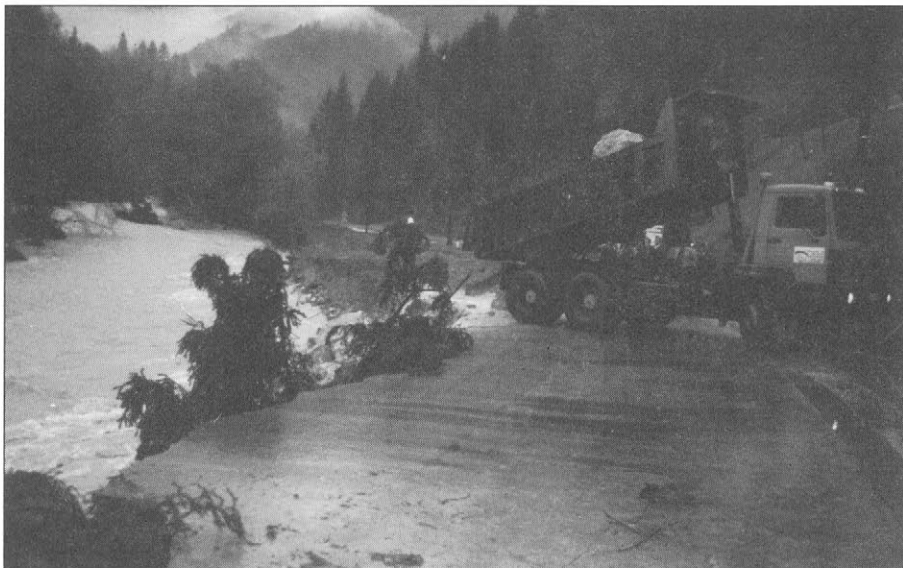
Slika 2. Kamniška Bistrica je poškodovala cesto Kamnik–Kamniška Bistrica. Začasno nasipavanje kamnometov, da bi zaustavili povečevanje zajede.
