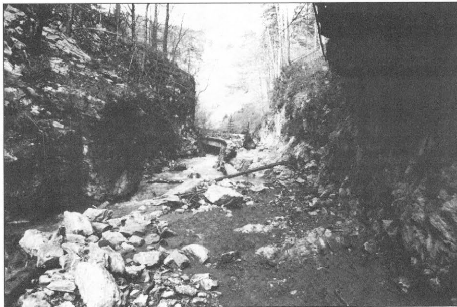
Slika 2. Zamašitev mostu je povzročila tudi porušitev davške ceste. (Foto: P. Pejakov).
