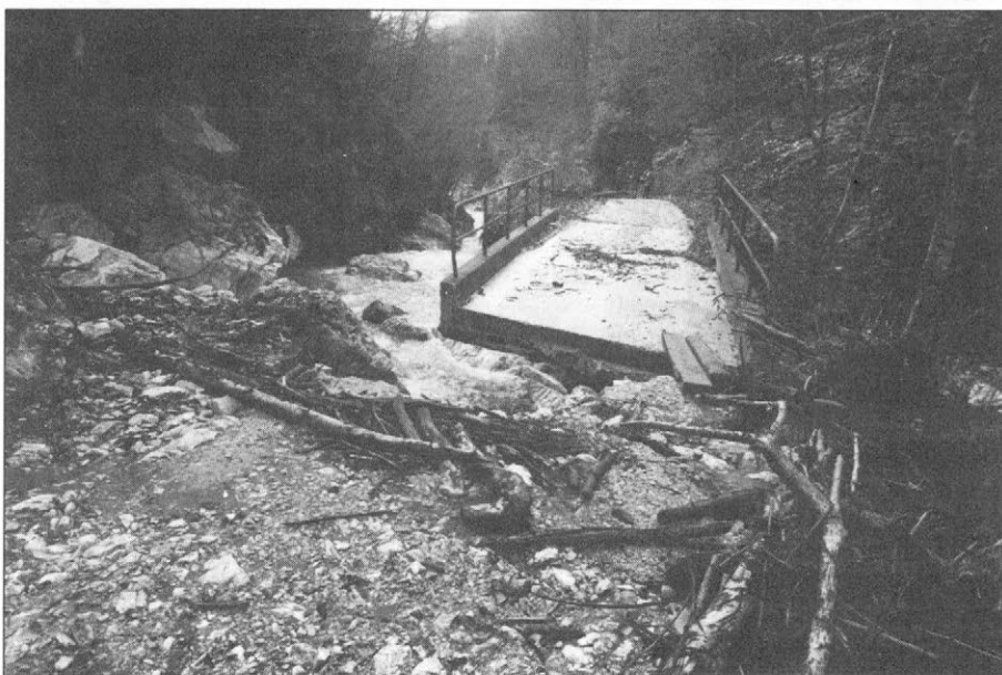
Slika 1. Most na začetku davške ceste je obvisel v zraku. (Foto: P. Pejakov).
