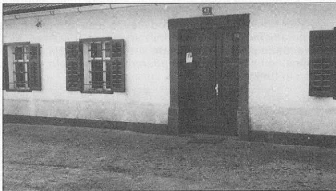
Slika 4. Na dvorišču Mlinarjevega doma (Krašnja 47) je segala gladina povodnji do 70 cm visoko. Voda je odnesla nasip, ki je bil med hišo in nekdanjim jezom in pustila na selišču pravo razdejanje.
