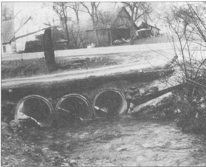
Slika 16. Tudi pri Vrankah je povodenj uničila in izpodkopala betonski most. Za zasilni prehod preko potoka so uporabili betonske cevi.
