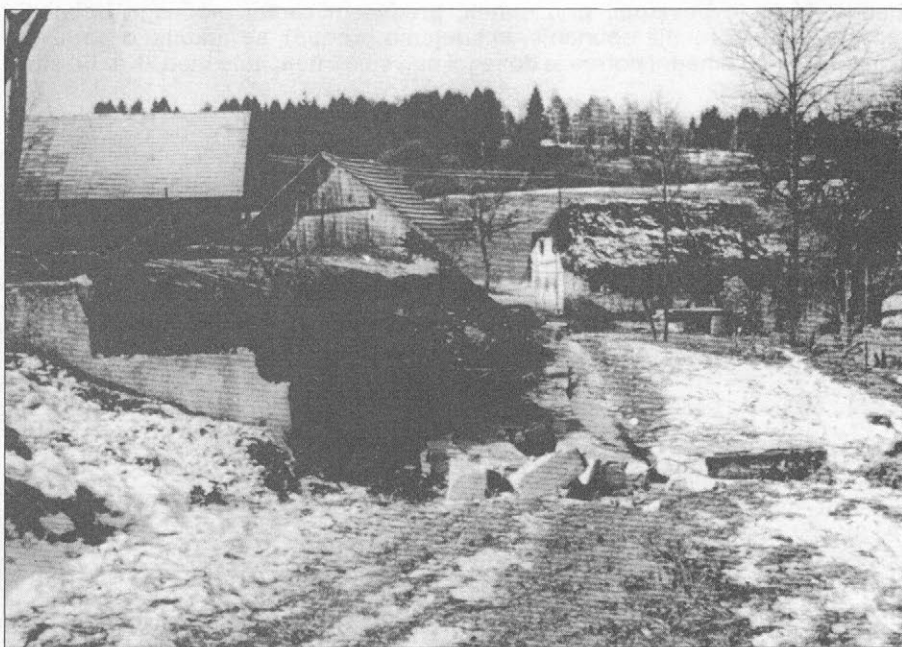
Slika 4. Pogled na podrti oporni zid, sezidan iz betonskih votlakov z armiranobetonsko povezo-vo na vrhu zidu. Zid je dolg 15 m in visok od 1,5 m do 2,8 m. (Foto: R. Vidrih).
