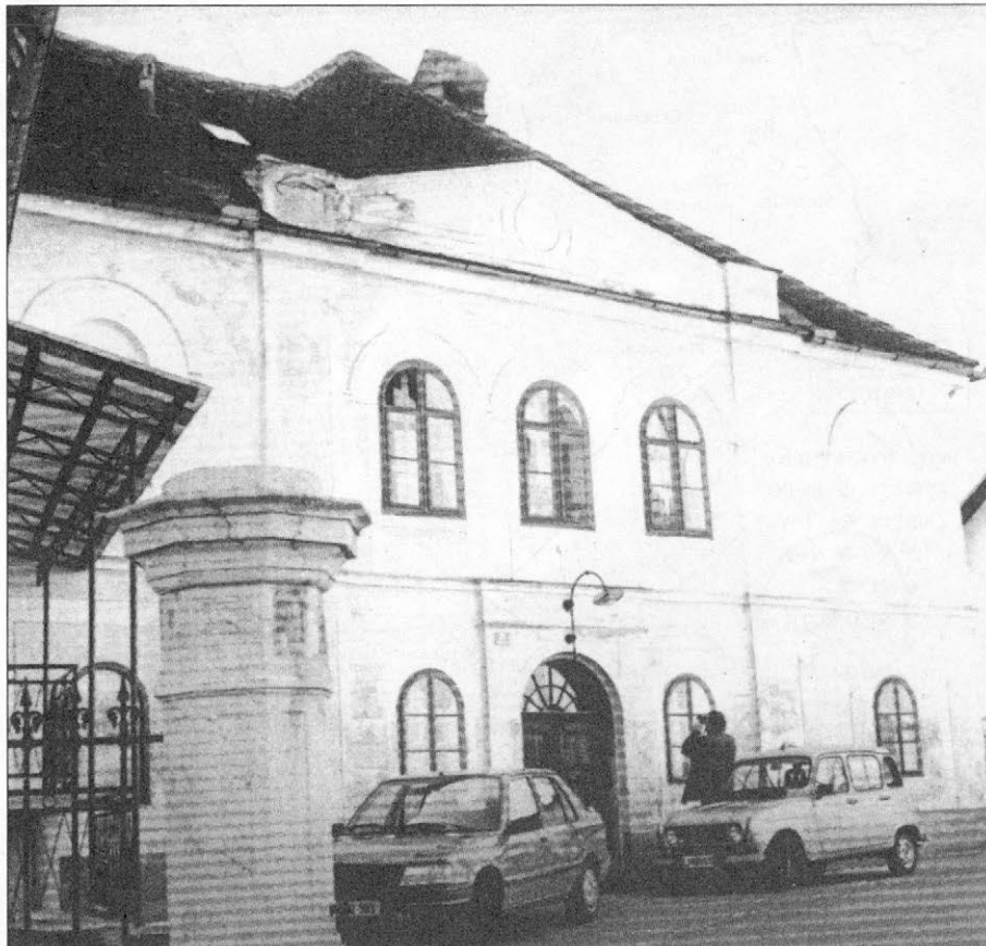
Slika 4. Župnišče v Vrhniku. Okoli 200 let star objekt se je različno stresel, zato so nastale manjše poškodbe. (Foto: R. Vidrih).
