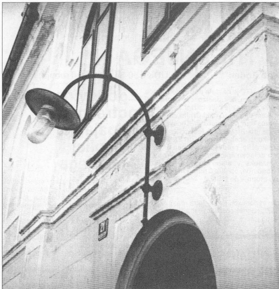
Slika 5. Med potresom je odpadel del štukature nad vhodnimi vrati. (Foto: R. Vidrih).
