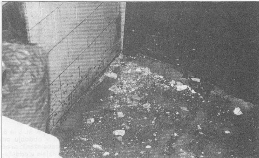
Slika 10. Pogled na odpadle večje kose ometa, ki so ležali vsepovsod po tleh objekta. (Foto: R. Vidrih).
