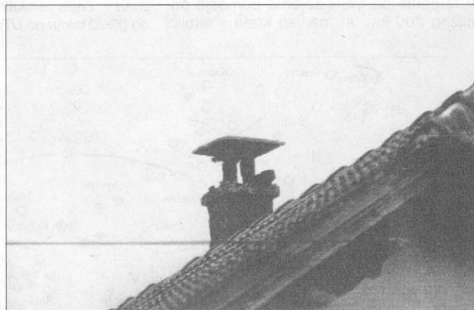
Slika 6. Pogled na delno odlomljen dimnik. Med potresom se je dimnik zasukal za 40°. (Foto: M. Godec).
